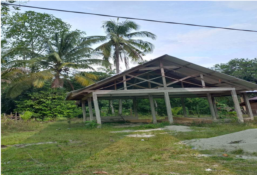
Rumah warga yang rusak
