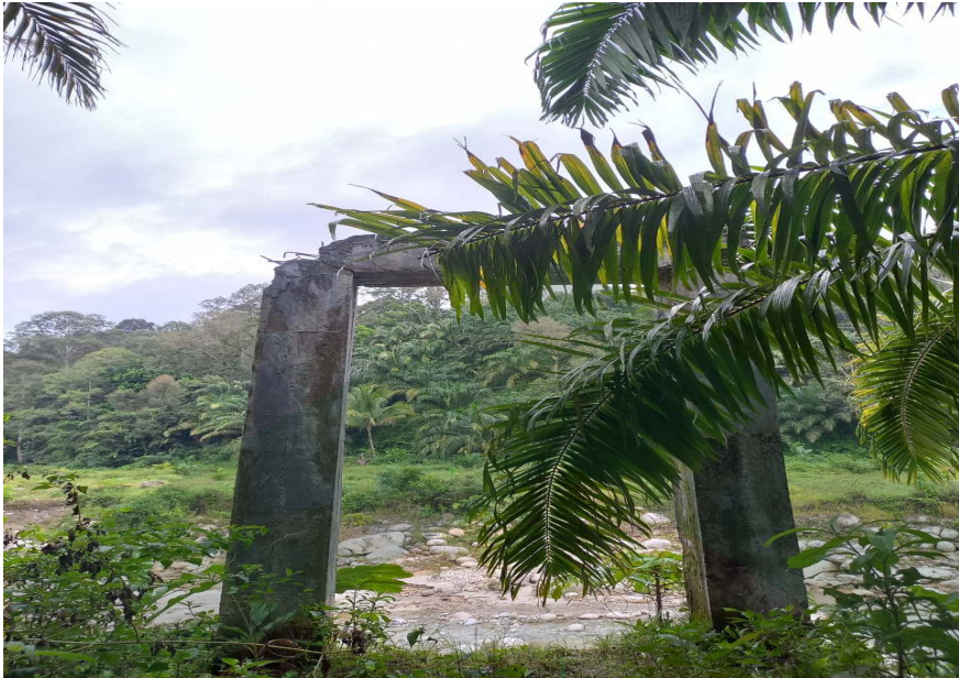
Jembatan gantung yang terputus
