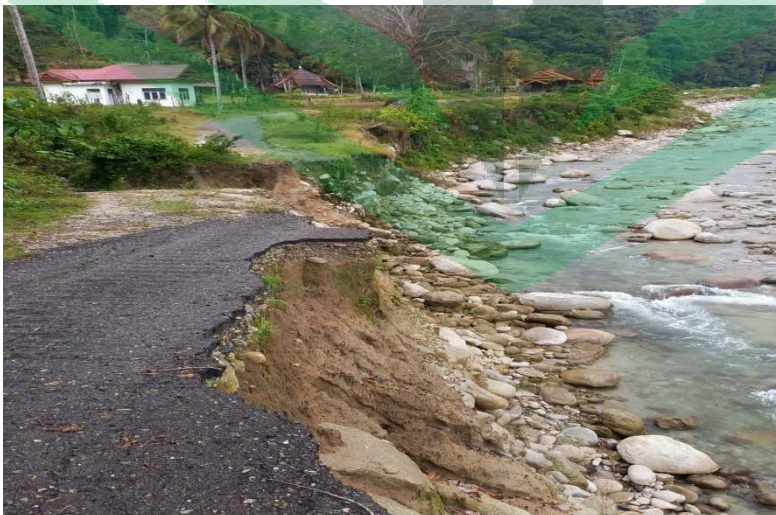
Jalan poros utama yang rusak
