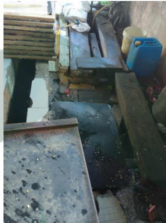
Gambar.4.1 (saluran pipa air rebusan tahu tempe)
